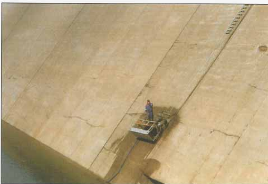
FIGUR 2 Opphugging av betongen sommeren 1996. Merk de horisontale sprekker og frilagt armering flere steder.
