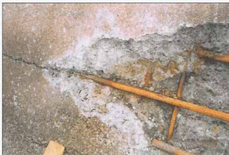
FIGUR 3 Opphugget betong. Merk at det kun finnes begynnelsen av overflaterust på armeringen.
