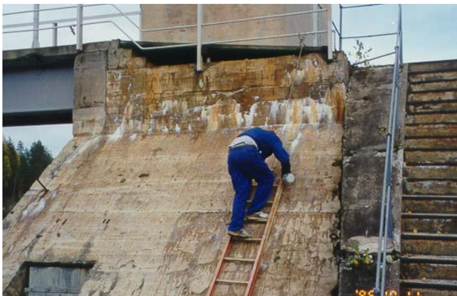
Betongdam bygd rundt 1950 hvor skadelig alkalireaksjon er forårsaket av 2 typer bergarter som ikke står på negativlisten. Rissutvidelse er målt til 0,25 mm per år.
