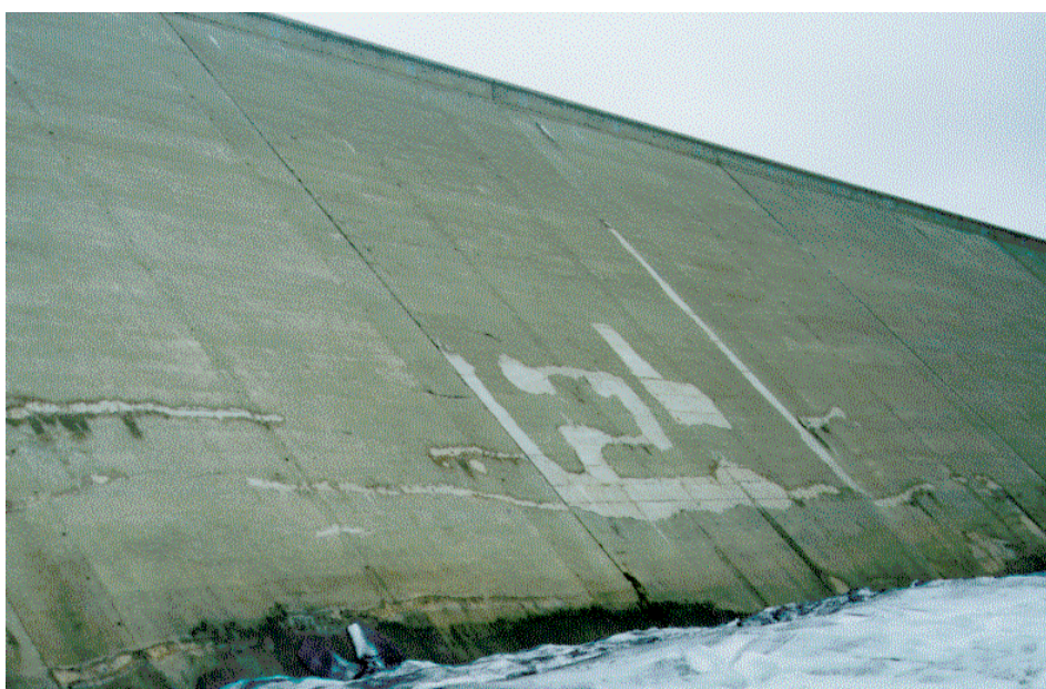
Betongdam bygd rundt 1960 hvor alkalireaksjon ikke er funnet selv om betongen inneholder alkalireaktive bergarter i passende mengder og det er anvendt norsk standardsement. Skadene på damplater er forårsaket av glidestøp.
