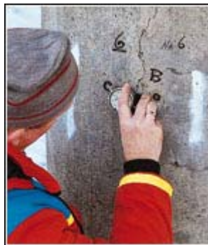
Her måles bredden på sprekke i en av pilarene på Elgeseter bru.
