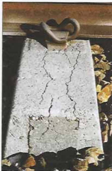
Sviller produsert i Verdal i 1973. Det ses flere langsgående riss/sprekker ved svillendeenden.
